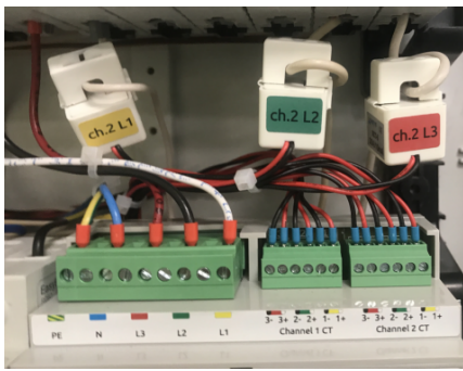
Подключение токовых трансформаторов
