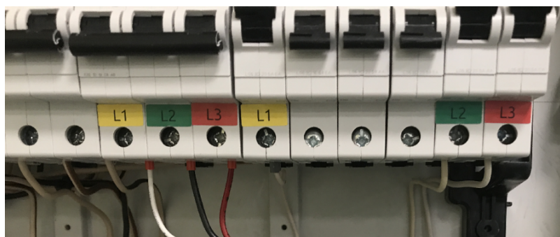
Маркировка фаз на автоматах
