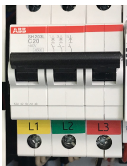
Маркировка фаз на вводе в щит
